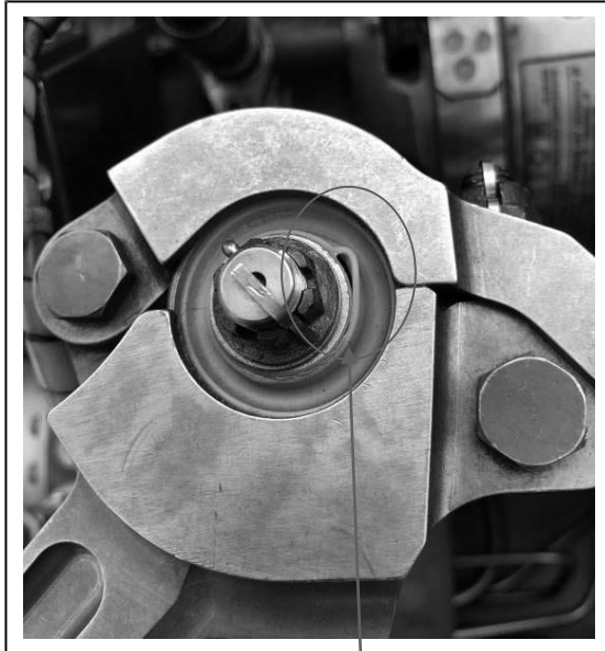
ブッシングのゴム部分の不具合箇所
